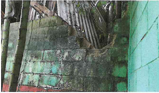
Foto1: Muro perimetral dañado.
