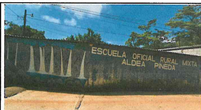
Foto 10: Pintura del muro exterior de la escuela en malas condiciones.
