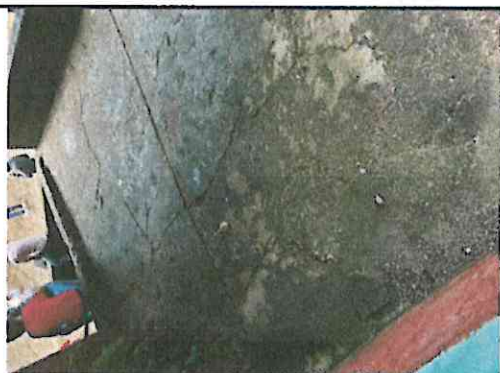
Foto 9: Losa de patio en malas condiciones.
