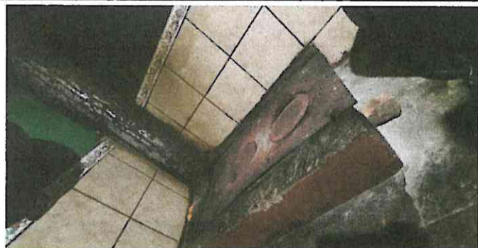
Foto 7: Plancha de estufa rural dañada.
