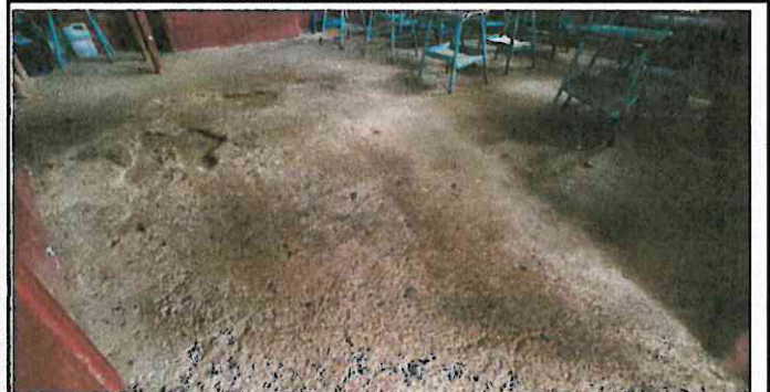
Foto 6: Torta de concreto dañada en salón de clase.
