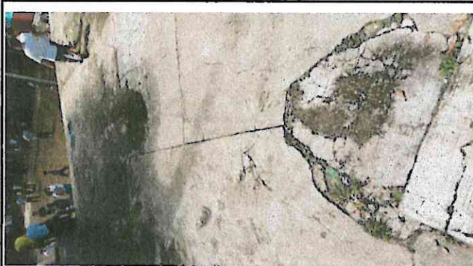
Foto 8: Losa de patio en mal estado.
