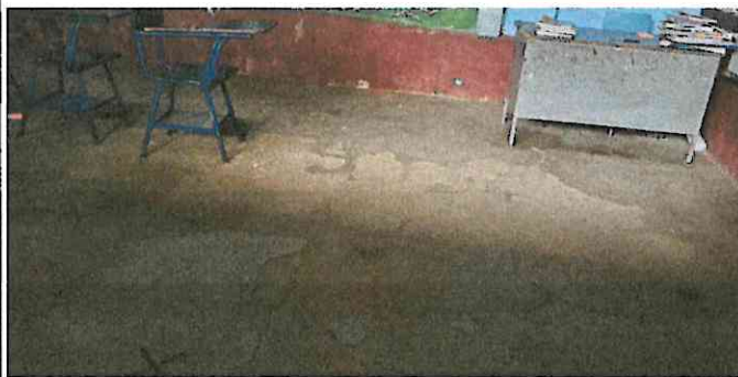
Foto 5: Torta de concreto dañada en el salón de clase.
